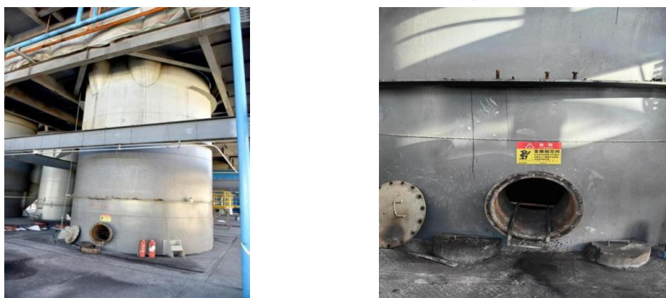
图 6-7 1#气化炉二楼平台人孔
